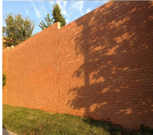
Figura 12: Muros de los tres condominios de estudio: Casa Grande, Alboretum y Jardín Otoñal.
